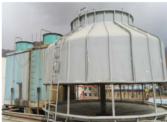
提取车间空调冷却系统
