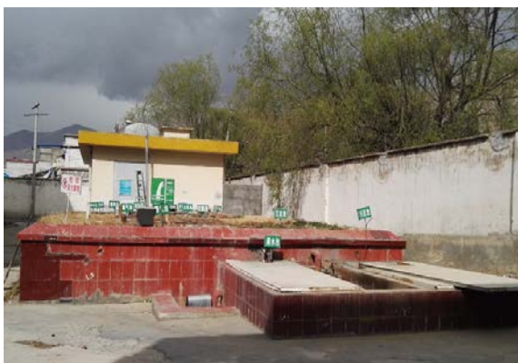
项目污水处理站
