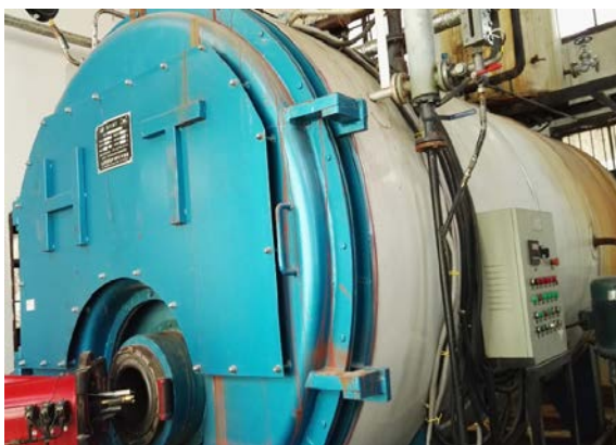
高压蒸汽锅炉
